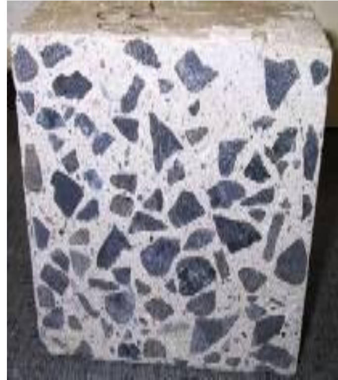
Hasil beton yang tidak bagus (Tidak kompak)
