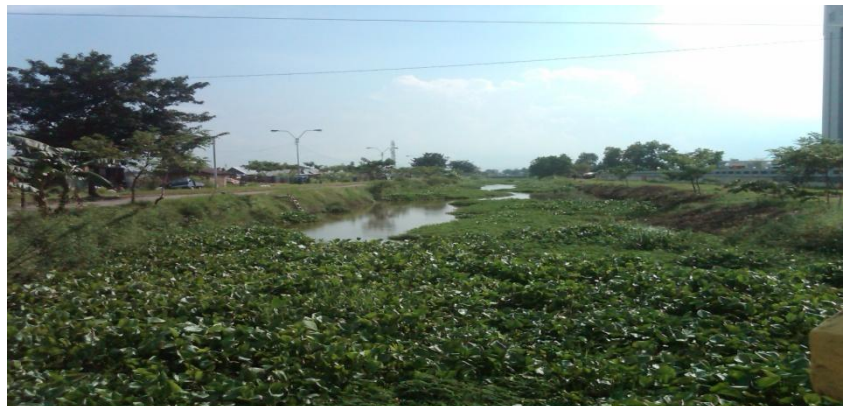
Gambar 6 : Keadaan Saluran Akibat Sedimentasi
