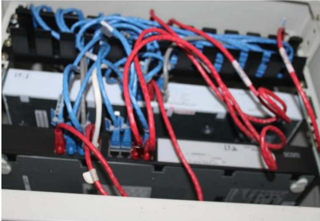
(Gambar 4.7 penggunaan kabel cross di LAPAN)
