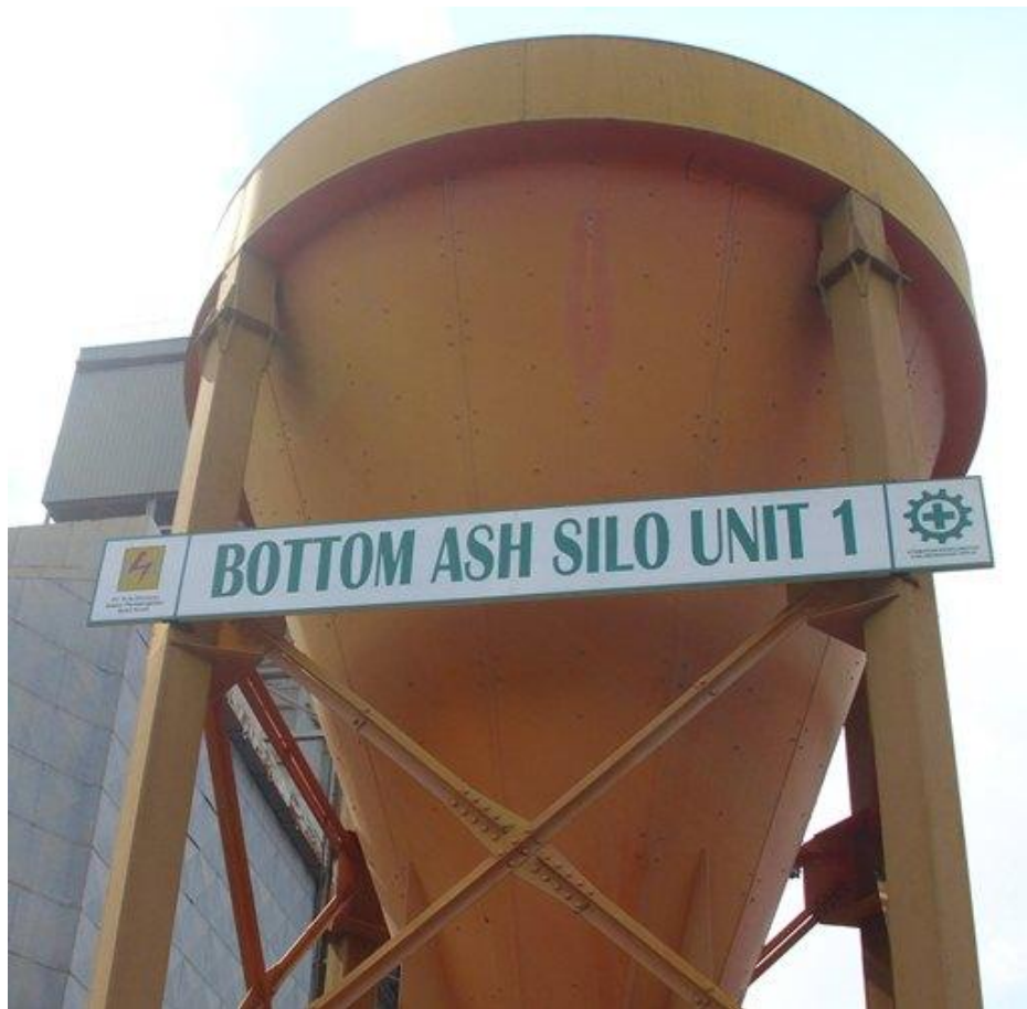
Foto. Wadah penampungan Bottom Ash PLTU Bukit Asam
