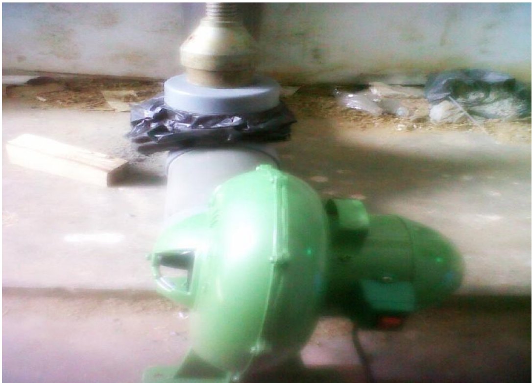
Foto. Fan Blower untuk penyaringan fly ash
